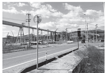
巨大な仮設のベルトコンベアで山から沿岸部に土砂を運ぶ (陸前高田での復興事業風景)
