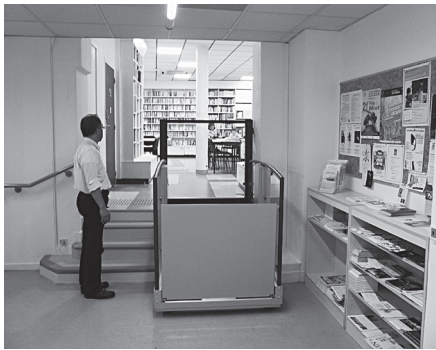
図書室入口に新設された簡易エレベーター(2014年9月12日撮影)
